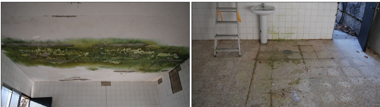
Estado del interior del local
