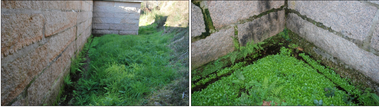
Acumulación de agua en la cuneta perimetral den tierras
